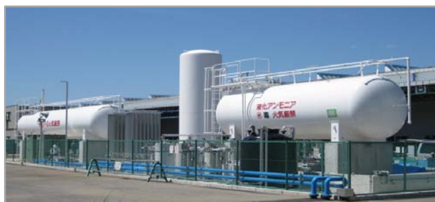
アンモニアガス供給プラント
