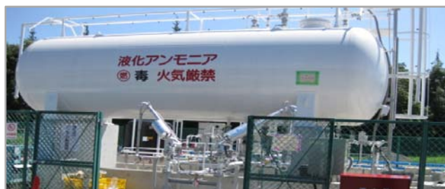
液化アンモニアタンク、受入設備
