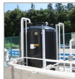
アンモニア除害タンク設備
